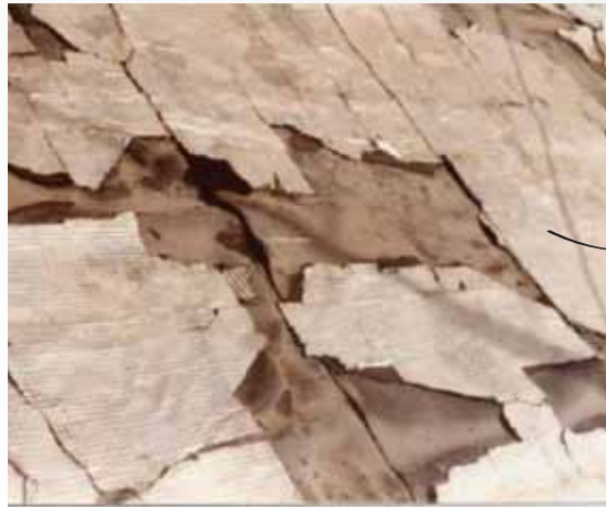
Cobertura em terraço com revestimento de impermeabilização degradado (a precisar de reparação)
