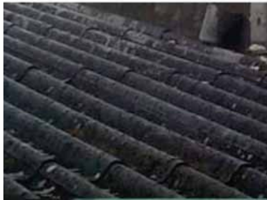
Cobertura inclinada (a precisar de reparação) sobre esteira resistente
