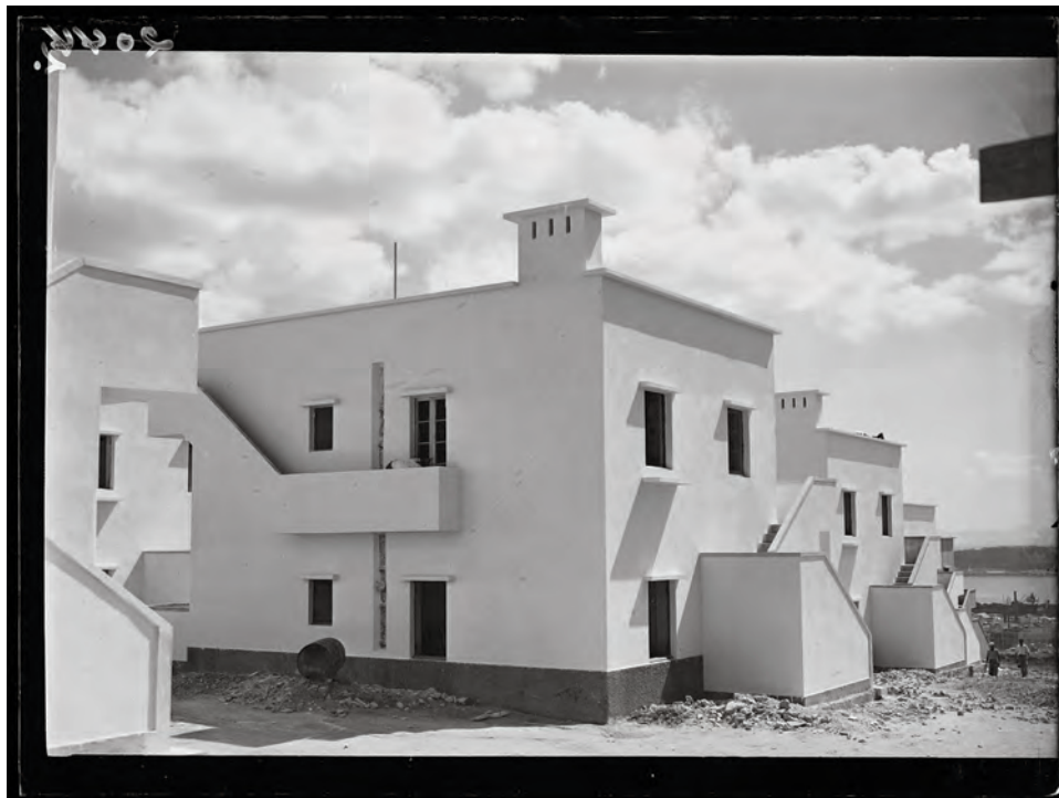
FIG. 6 «Bairro Económico do Alvito. Casas em construção para os operários da Câmara Municipal de Lisboa», Lisboa, 15 de setembro de 1937 (arquiteto Paulino Montez, 1937-1944). ANTT/EPJS.
